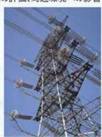
試験用の器具を取り付けた鉄塔
