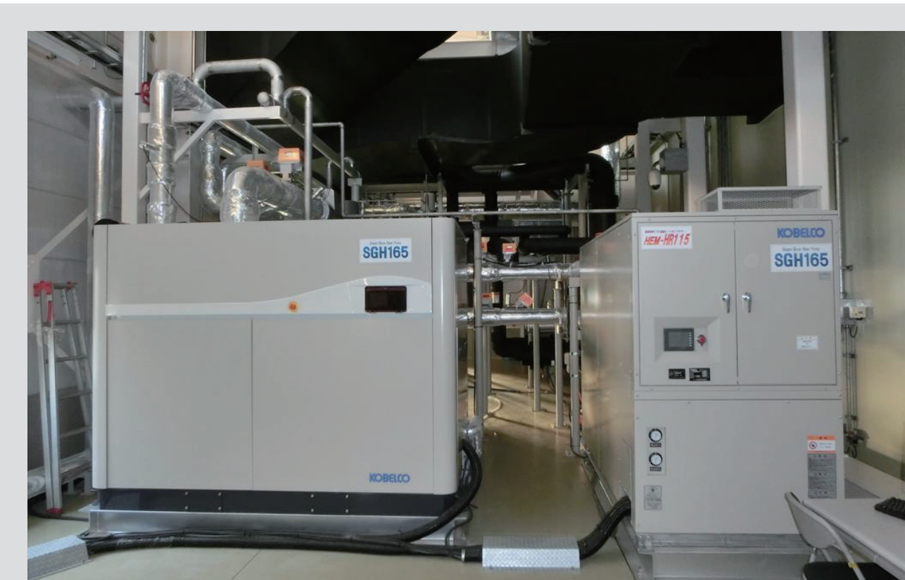
産業用ヒートポンプの性能評価試験設備
